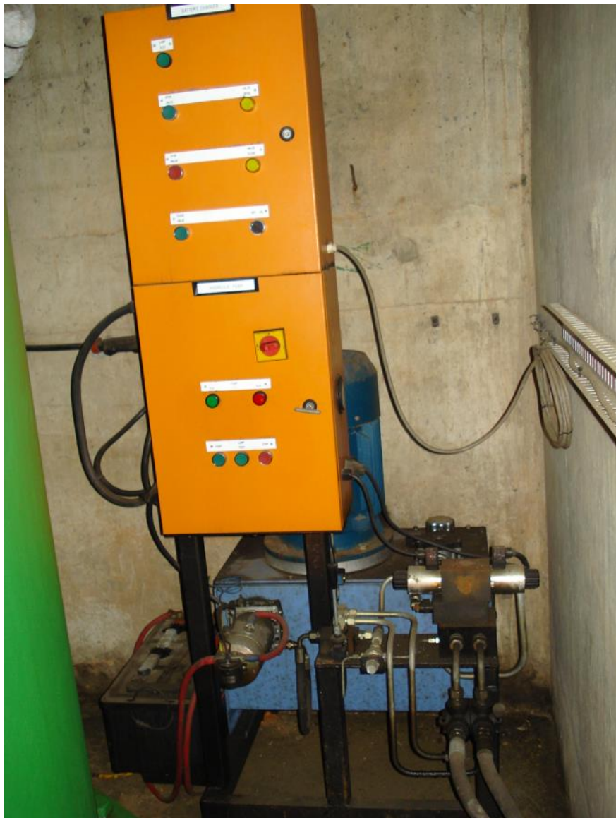
Goedertrouw dam: Tower Hydraulic power pack
