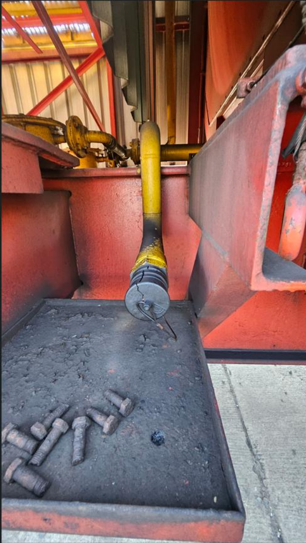
Mobile Bowser - Fill Point.jpg
